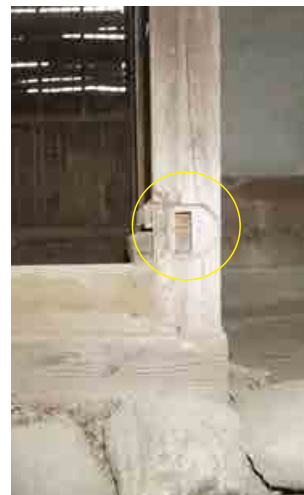
東面 縁持ち送り
